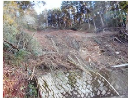
県道64号青野原に向かう路肩が崩落
