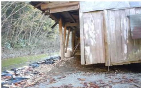
馬石橋下流の民家の小屋土台の土が流出
