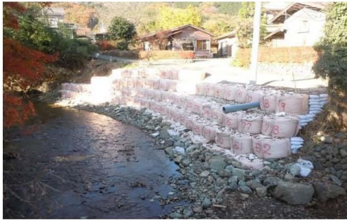
渡戸自治会館前の護岸が崩落
