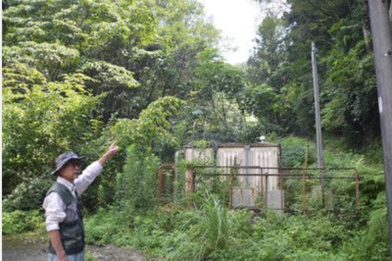
日本道路公団が茶園への引水のため設けたポンプ施設。実際に茶園に水を届けることなく老朽化した＝8月下旬、掛川市倉真
